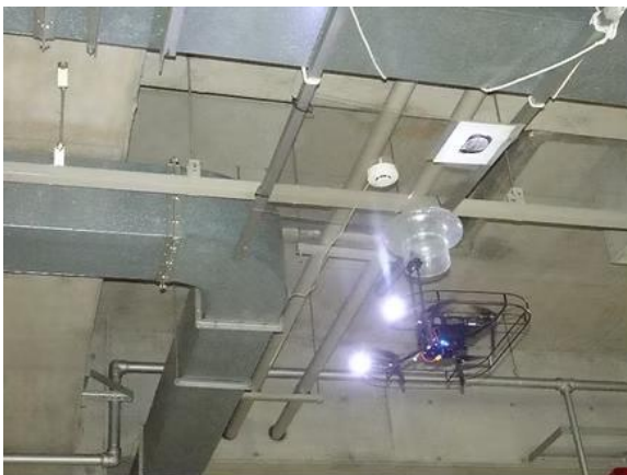
能美防災株式会社：煙感知器用加煙試験器 搭載ドローン
