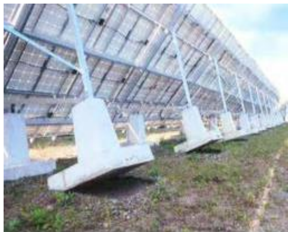
強風で架台が持ち上がり傾き
