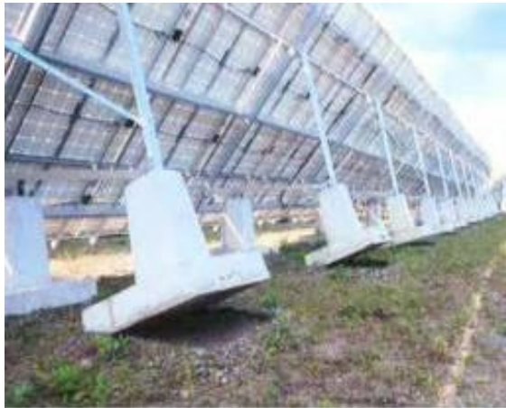
強風で架台が持ち上がり傾き
