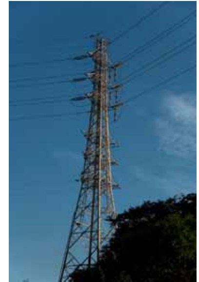
送電用の鉄塔
